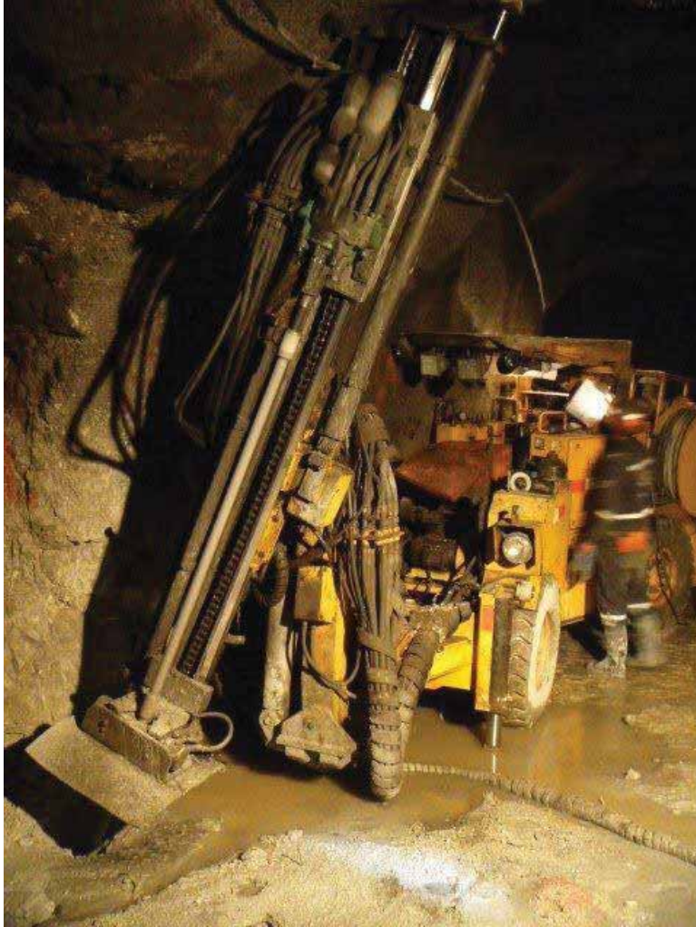
Figura 20. Uso de Equipo Mini Raptor para Taladros Largos. Fuente: Área de mina – Huarón.
