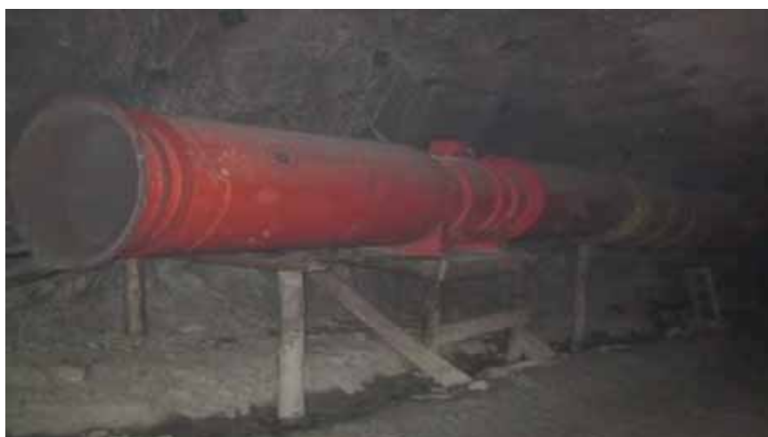
Figura 43 ventiladores de 100 000 CFM Minera Arcata. Fuente: fotografía propia mina Arcata
