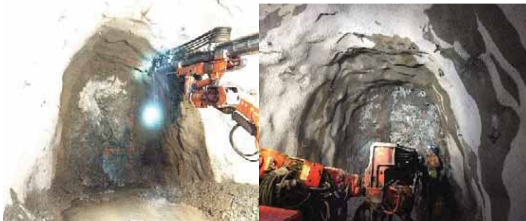
FIGURA 29. Perforación de frente sin cumplir parámetros
