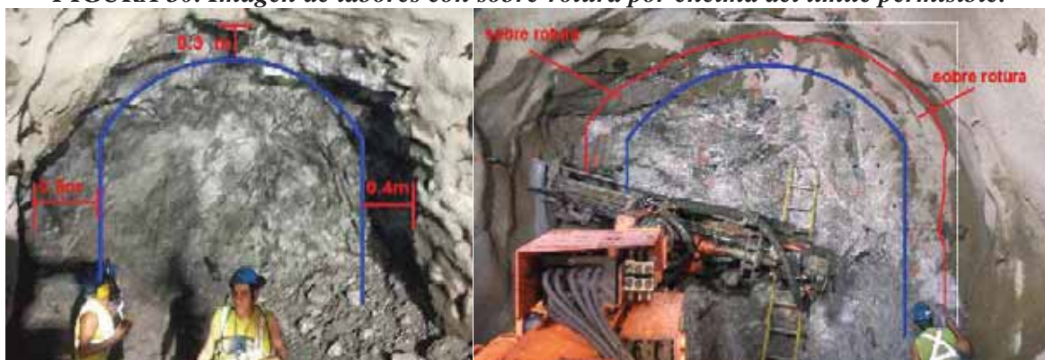
FIGURA 30. Imagen de labores con sobre-rotura por encima del límite permisible.
