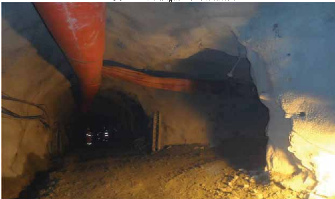
FIGURA 21. Mangas De ventilación
