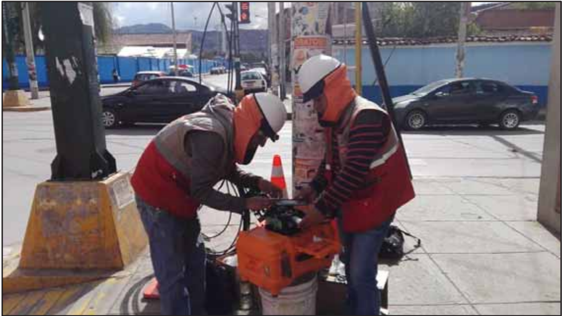
Fig. 7.4 Instalación de los Adaptadores de Red en el Gabinete
