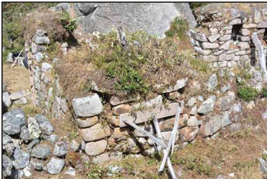
Foto 15. Apuntalamiento y grietas de muro. Sitio Arqueológico de Bateachayoq 2017. Foto de los autores.
