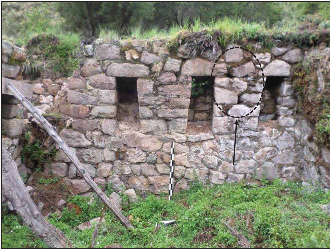
Foto 55. Fisuras y grietas al interior del recinto 01. Sitio Arqueológico de Bateachayoq. Foto de los autores.
