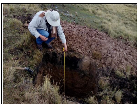
Foto 11. Medición de la profundidad de excavación de la calicata N° 3 en la progresiva del km 02 + 781.
