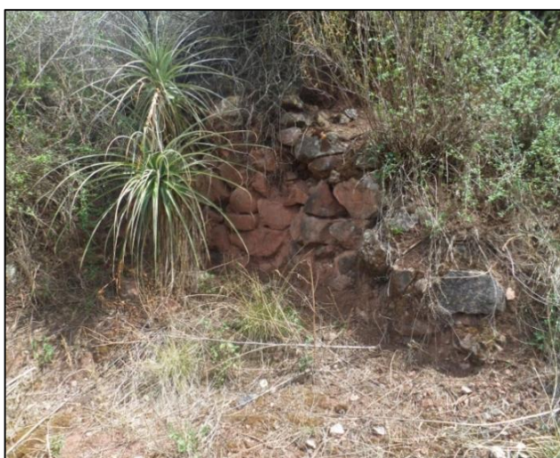
Fotografía N° 48: Vista del muro frontal del recinto 03-W, notándose su mal estado de conservación. Fuente propia.
