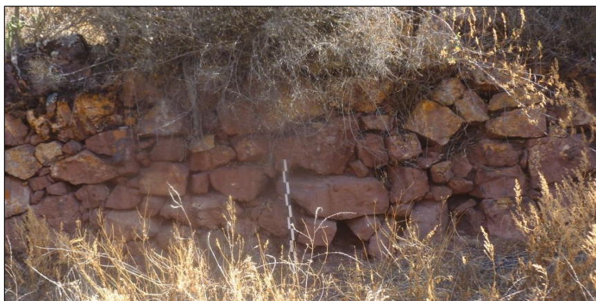
Fotografía N° 576: Vista del muro del andén 20-W, un muro de aparejo rústico. Fuente propia.
