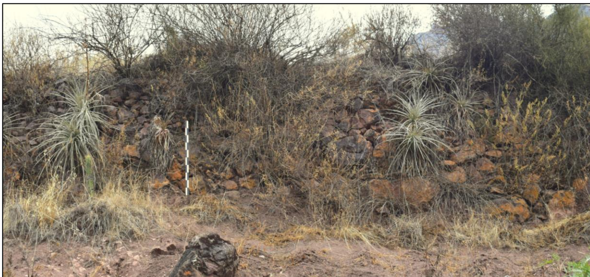
Fotografía N° 554: Vista del andén 03-W, donde se evidencia vegetación arbustiva y gramínea como los principales agentes de deterioro del muro. Fuente propia.
