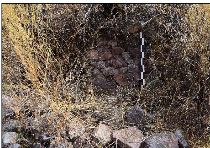
Fotografía N° 45: Vista frontal del recinto 01-W, donde se muestra el deslizamiento de sus muros. Fuente propia.
