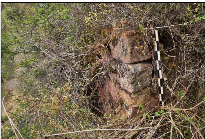
Fotografía N° 8: Vista del recinto 04-K, se puede apreciar el mal estado de conservación. Fuente propia.
