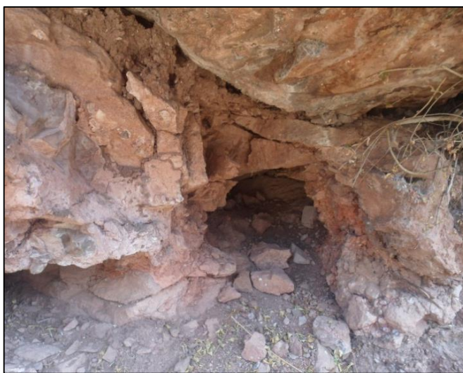
Fotografía N° 43: Vista de la estructura funeraria 02-W, se aprecia el pésimo estado de conservación. Fuente Propia.
