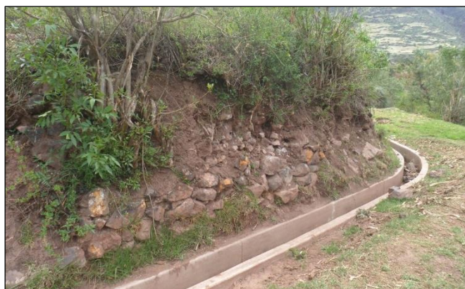
Fotografía N° 565: Vista del muro del andén 09-W, donde se evidencia una construcción moderna de un canal de agua que corta el. Fuente propia.
