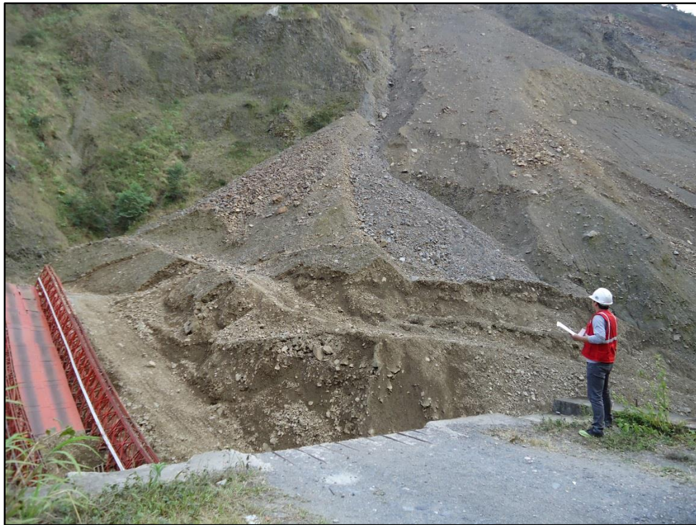
Foto N° 17. Depósitos del deslizamiento de Mesacancha. Se aprecia también el puente que colapso Km 12+040. (W. Atauchí R. / A. Hacha S.)
