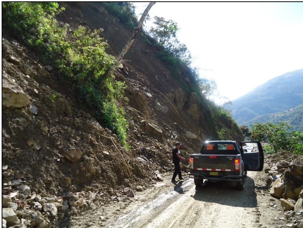
Foto N° 9. Remoción en masas en la progresiva Km 4+230. (W. Atauchí R. / A. Hacha S.)
