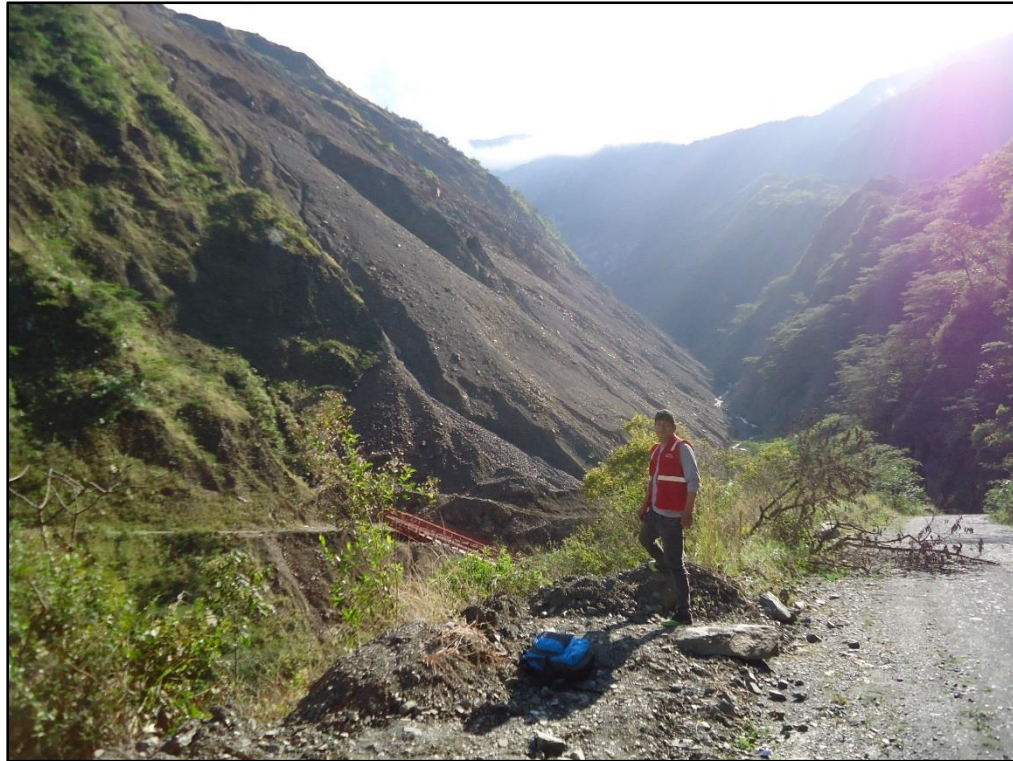
Foto N° 10. Se aprecia el deslizamiento de Mesacancha. (W. Atauchí R. / A. Hacha S.)
