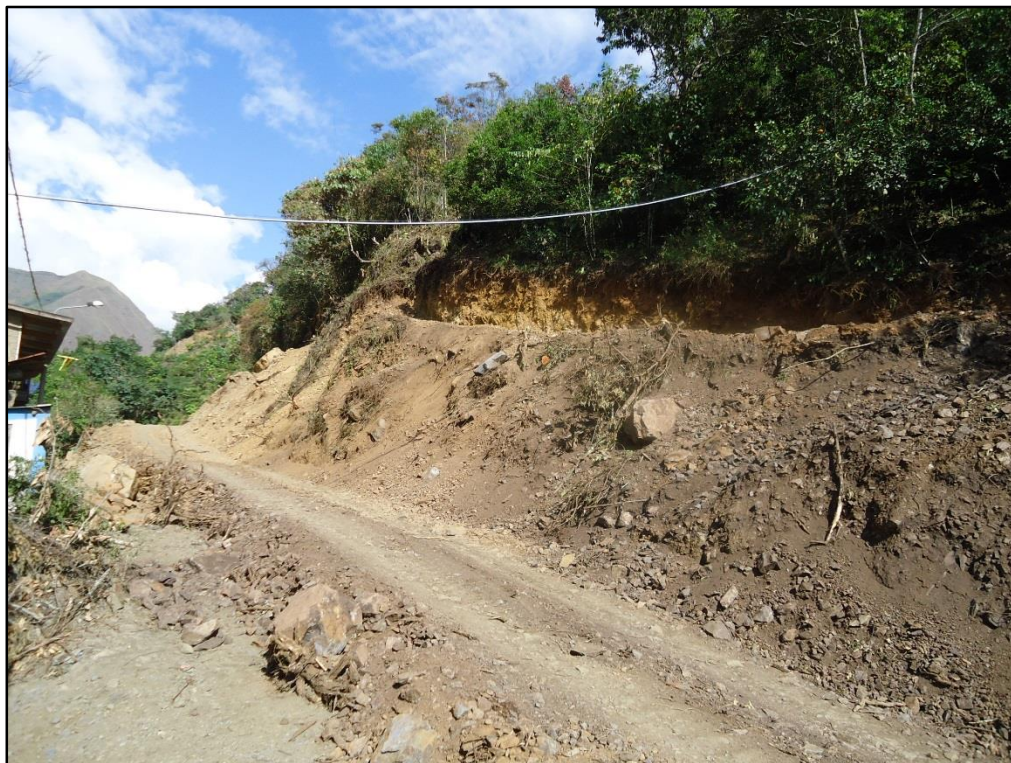
Foto N° 16. Depósitos coluviales, Km 5+230. (W. Atauchí R. / A. Hacha S.)
