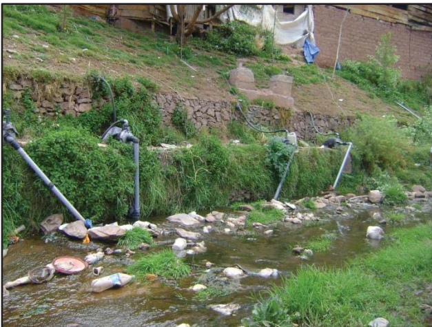
Foto 31: Extracción de agua del río Huatanay por medio de motobombas altura Huancaro
