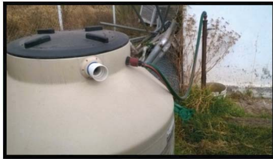
Fotografía 13: Fuente de agua y tanque almacenador de agua.
