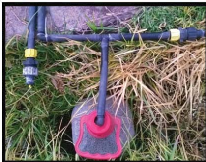
Fotografía 24. Instalación de los bidones medidores agua de riego.
