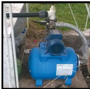
Fotografía 15. Sistema de presión constante y bombeo de agua
