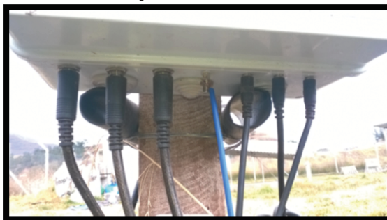
Fotografía 39: Electroválvulas y sensores conectados al controlador de riego.
