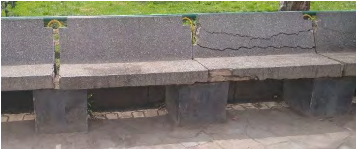
Nota. El gráfico muestra las grietas de las bancas en la plaza cívica. Elaboración propia, 2024
