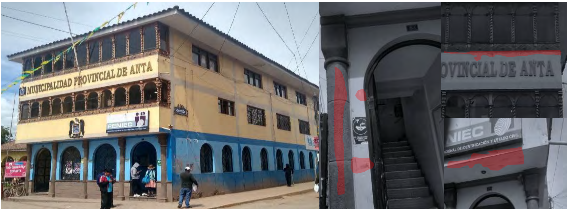
Figura 49 Deterioro ambiental de la fachada
