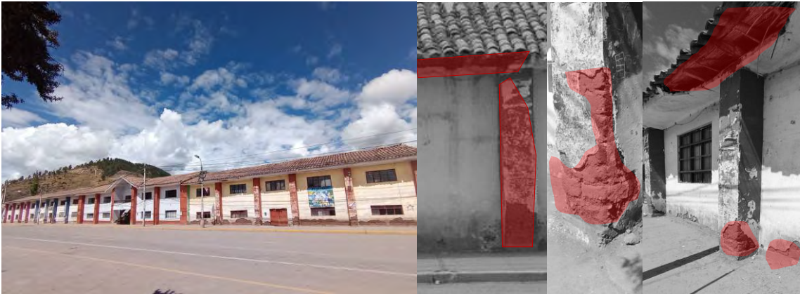
Figura 53 Deterioro antrópico, ambiental y mecánico en el inmueble
