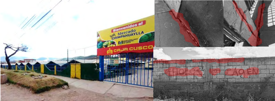
Figura 57 Deterioro ambiental, mecánico y antrópico en la feria Chimpahuaylla
