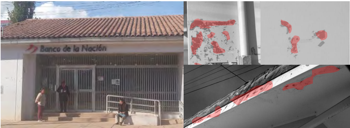
Figura 54 Deterioro ambiental en el inmueble del Banco de la Nación
