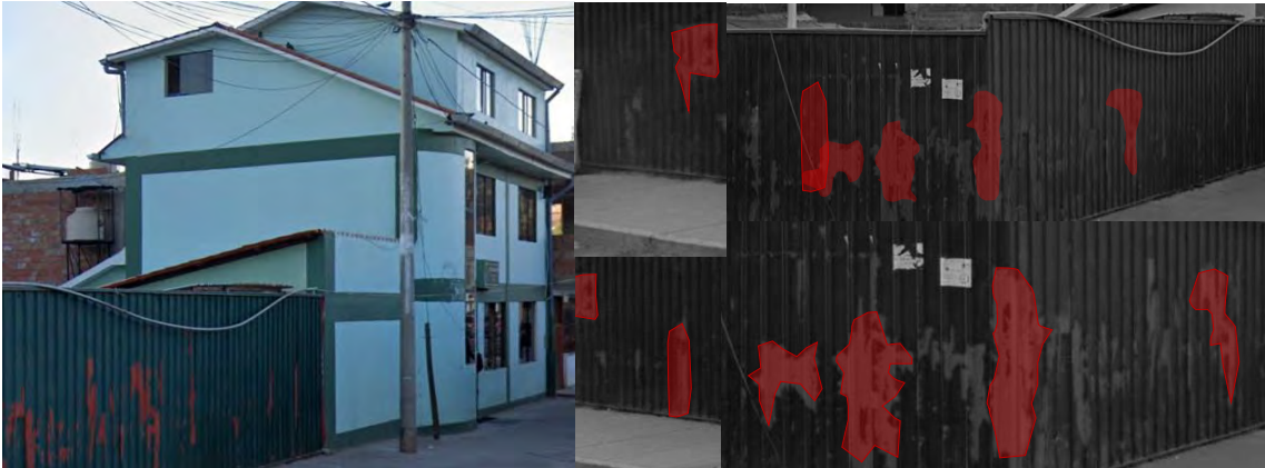
Figura 52 Deterioro ambiental en la comisaría
