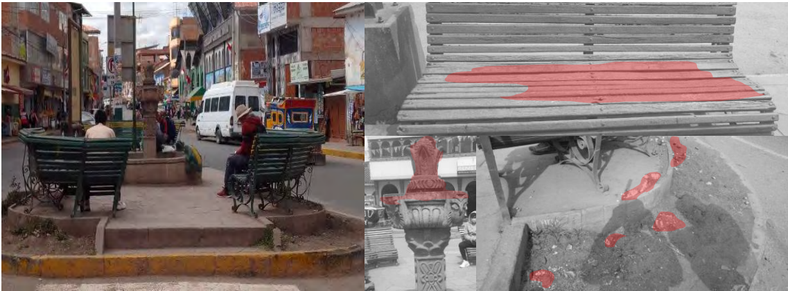
Figura 50 Deterioro antrópico, ambiental y mecánico en los mobiliarios
