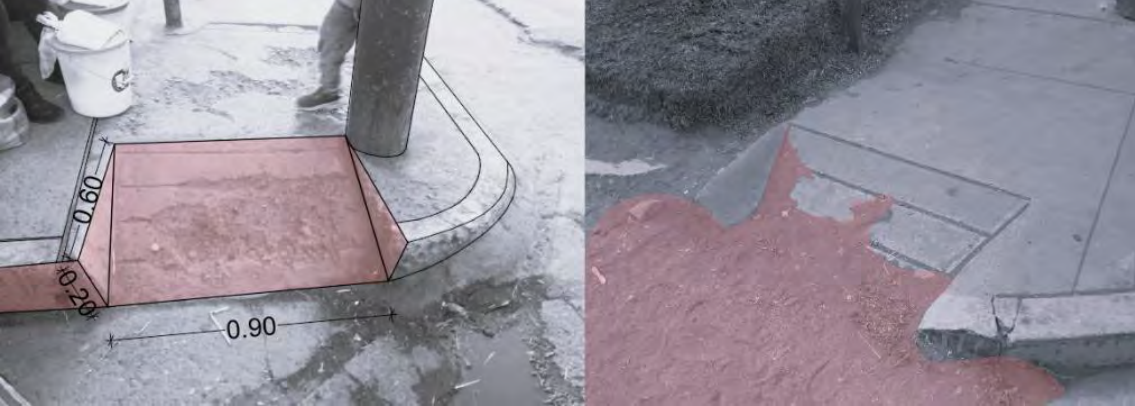
Figura 10 Rampa con deterioro mecánico-material orgánico
