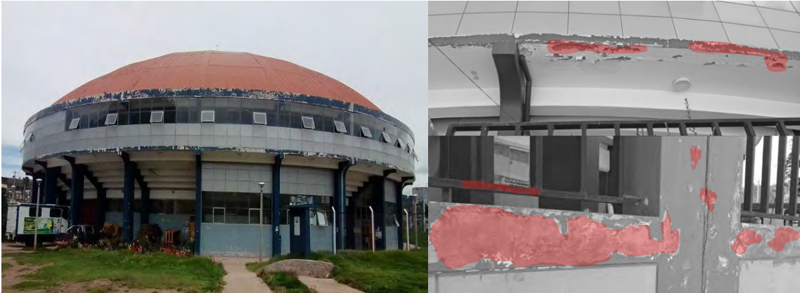
Figura 58 Deterioro ambiental por humedad y decoloración en el coliseo
