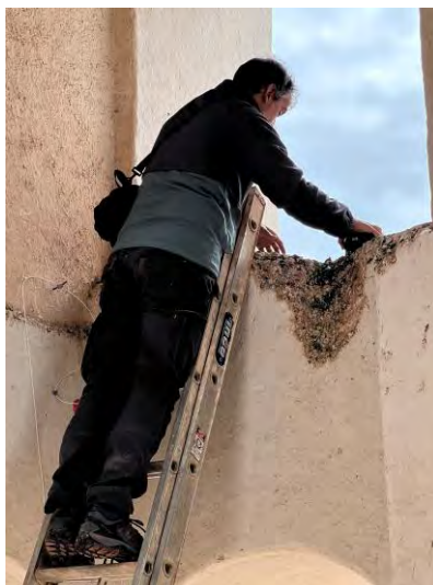
Instalación de Geófono
