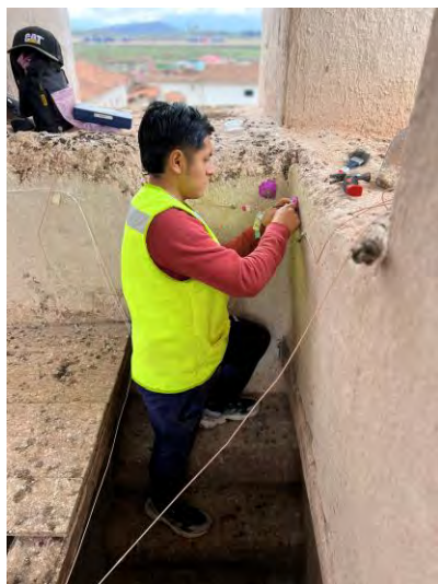
Instalación de Acelerómetros
