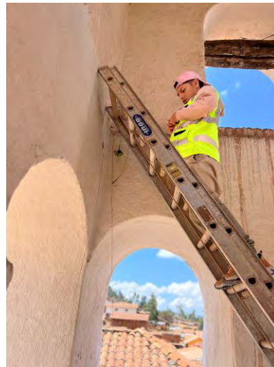
Instalación de Acelerómetros
