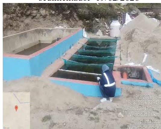
Toma de muestras de agua a ingreso de sedimentador 19/02/2026
