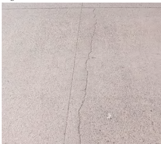
Fisura transversal de severidad baja (L) con abertura fina en pavimento rígido.
