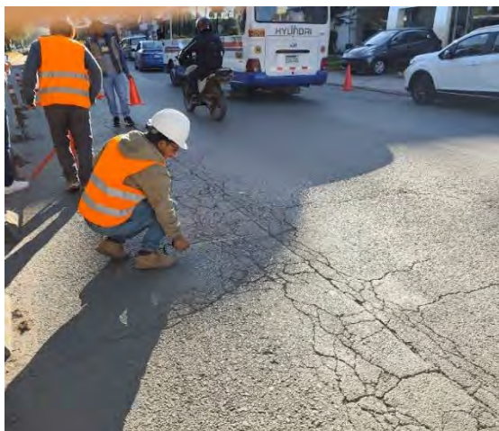
Grietas de borde de severidad media (M), con fisuración moderada en el borde del pavimento
