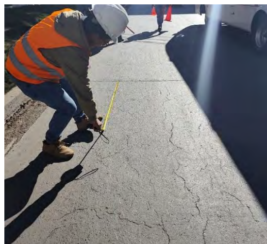
Fisuración multidireccional de severidad baja (L) con abertura fina en pavimento rígido
