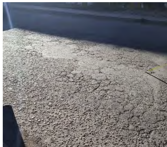
Piel de cocodrilo de severidad alta (H), con fisuración severa y desintegración del pavimento
