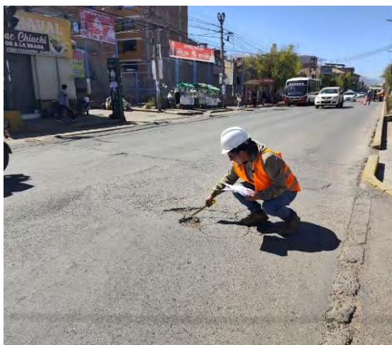
Huecos de severidad baja (L) con leve pérdida de material en pavimento flexible.
