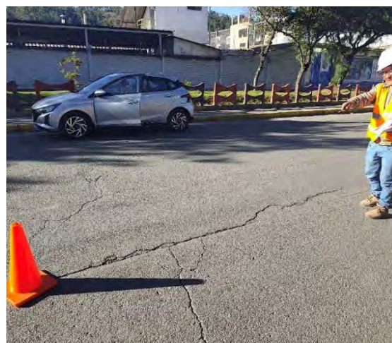
Fisura longitudinal de severidad media (M) con abertura moderada en pavimento
