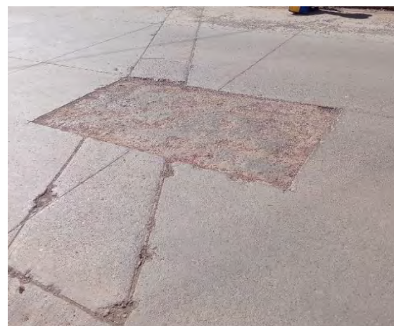
Parqueo de severidad baja (L) con leve deterioro superficial en pavimento rígido.
