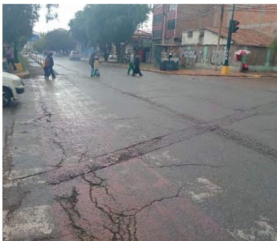
Parqueo transversal de severidad baja (L) con fisuración superficial en Pav. Flexible
