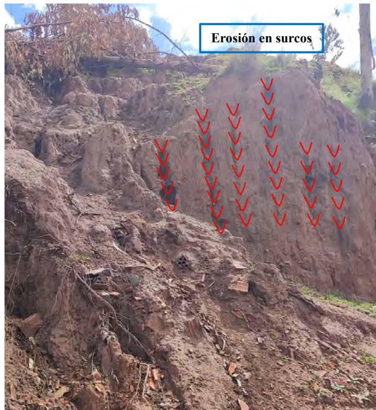
Fotografía 30. Vista de erosión en surcos
