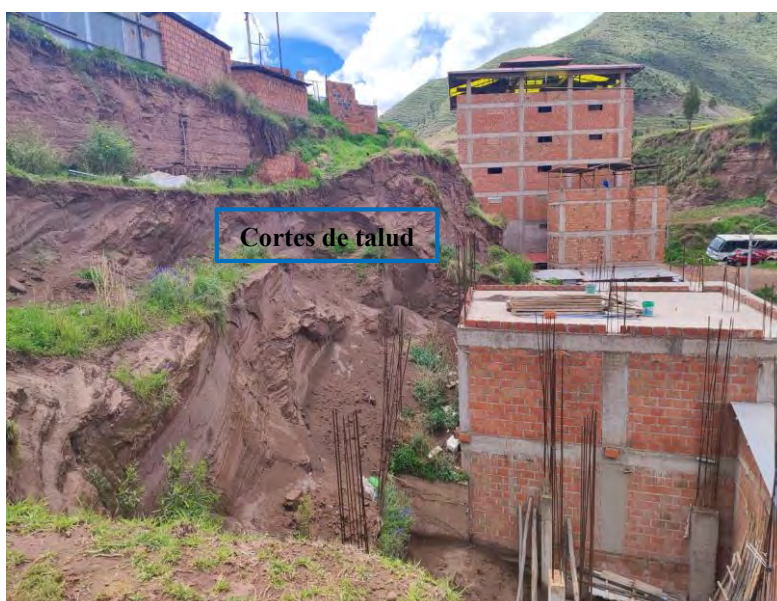
Fotografía 32. Cortes de talud en las laderas
