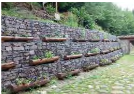
Imagen 14. Estructura con gaviones
