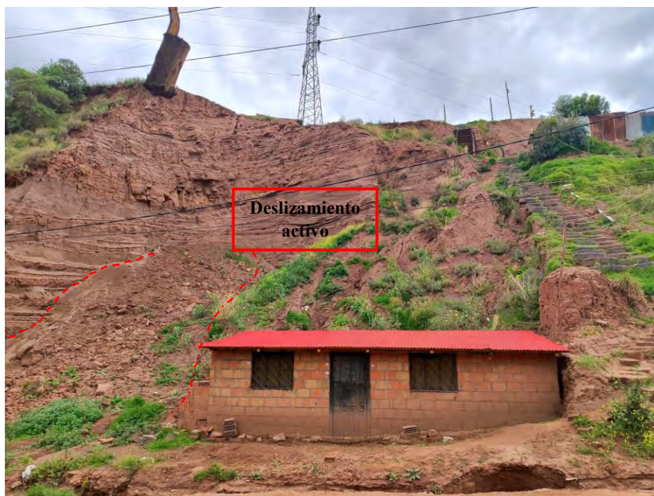
Fotografía 44. Deslizamiento activo producto del corte de talud y desarrollo de las viviendas
