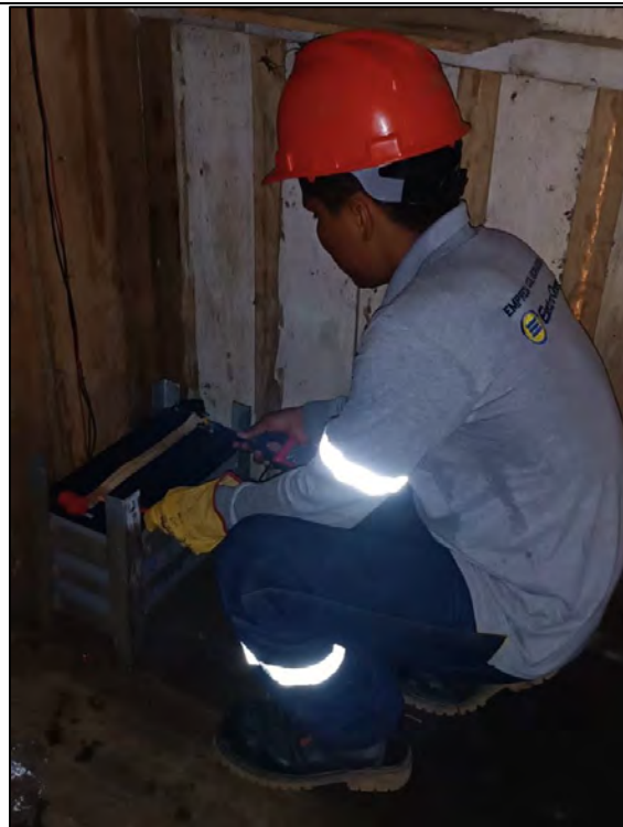
Medición de Parámetros Eléctricos de la salida - carga
