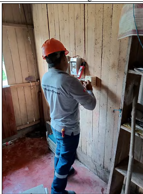
Inspección Minuciosa del Controlador DC
