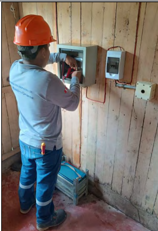
Medición de Parámetros Eléctricos del panel Fotovoltaico
