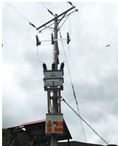
Subestación aérea monoposte ( tipo SAM)
