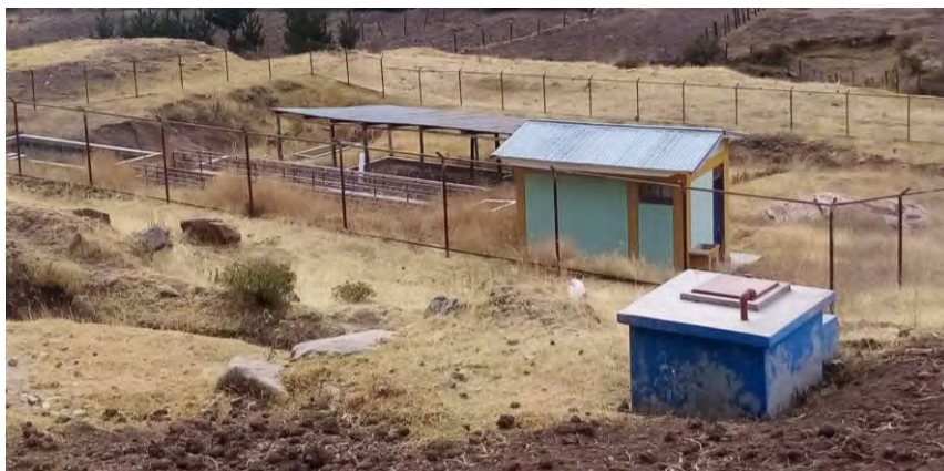
Imagen N.º 064: Planta de tratamiento de aguas residuales de urinsaya
