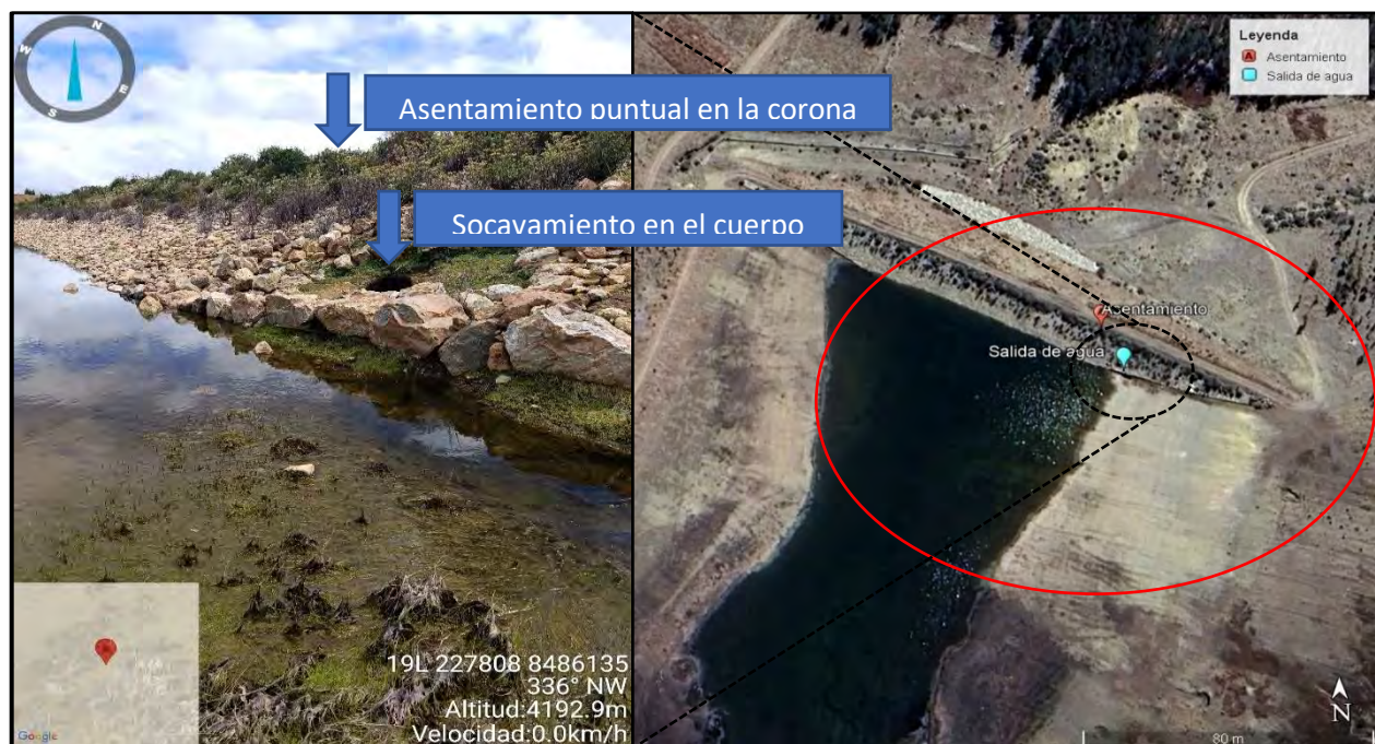
Figura 28. Hundimiento localizado en la corona y el socavamiento el cuerpo de la presa Qochaqocha.
