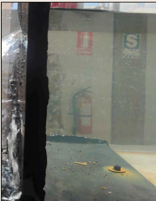
Acumulación de residuos y oxidación de pernos de anclaje por el no mantenimiento del vertedero
