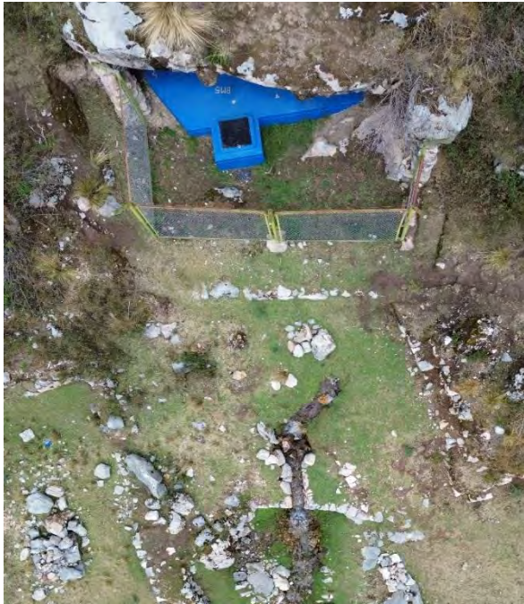
Captación de agua (01) del manantial (M-1)
