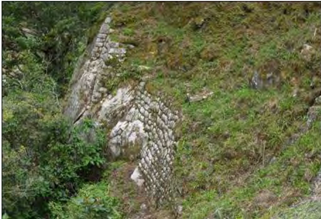
Figura 42. Vista parcial al tramo afectado por la desestabilización de la estructura producto de los agentes naturales
