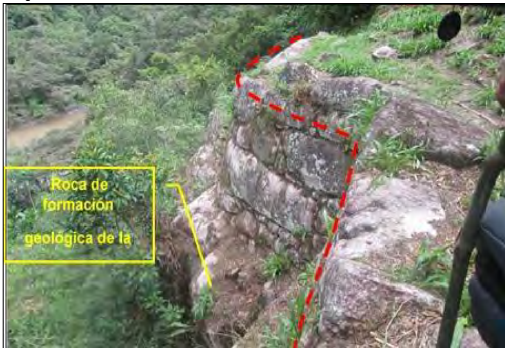
Figura 43. Construcción del muro de contención perimétrico sobre roca de formación geológica de la zona
