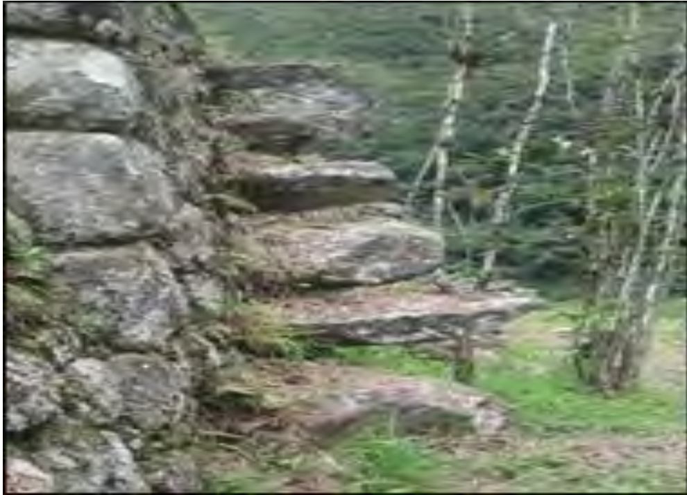
Figura 64. Escalones “Sarunas” construidos en el muro de contención longitudinal del muro de andén
