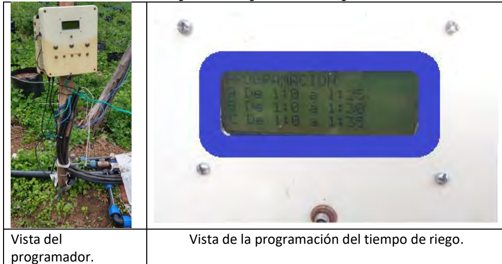
Fotografía 7: Programador de riego.
