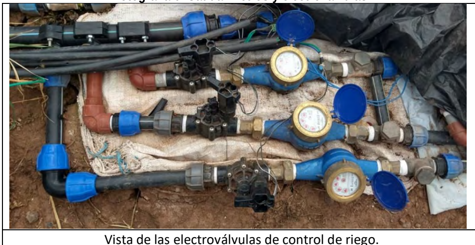
Fotografía 6. Caudalímetros y electroválvulas.
