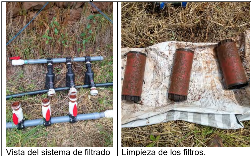
Fotografía 5: Sistema de filtrado.
