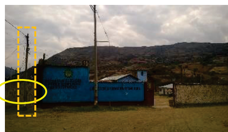
Figura 122. Red de energía eléctrica y el banco de medidores.
