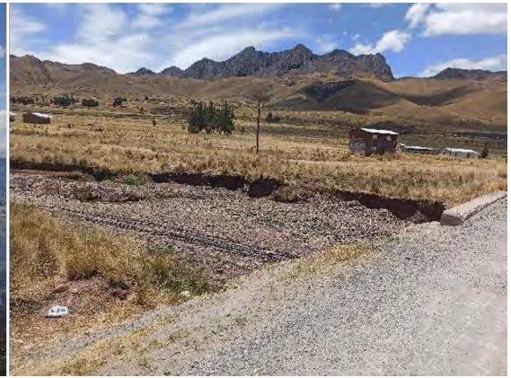
Foto 28. Flujo de agua sin canalización Km 6+715.
