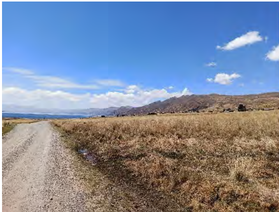
Foto 33. Zona con filtración de agua, se aprecia charcos al borde de carretera, Km 2+260.
