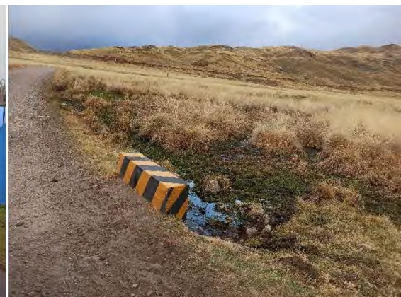
Foto 36. Zona de bastante húmedas que falta canalizarse y drenar, Km 40+800-40+820.
