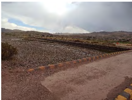
Foto 31. Puente Yuraccancha, con colmatación, y baja luz.
