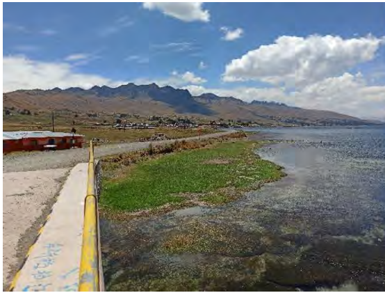
Foto 27. Margen de recha aguas arriba, en el puente Compuerta, se recomienda realizar mejor el enrocado.
