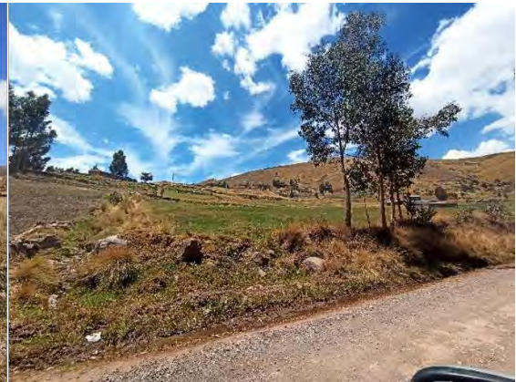
Foto 34. Zona húmeda con filtración que se aprecia en el borde de carretera, Km 12+080-12+500.
