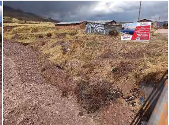
Foto 30. Margen izquierda agua arriba del puente Layo, considerar enrocado o muro de gaviones para evitar la erosión en los estribos del puente.
