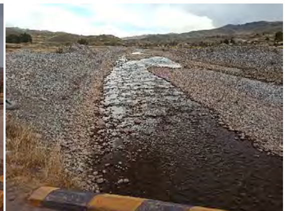
Foto 32. Puente Urinsaya Collana, colmatada y sin defensa ribereña.
