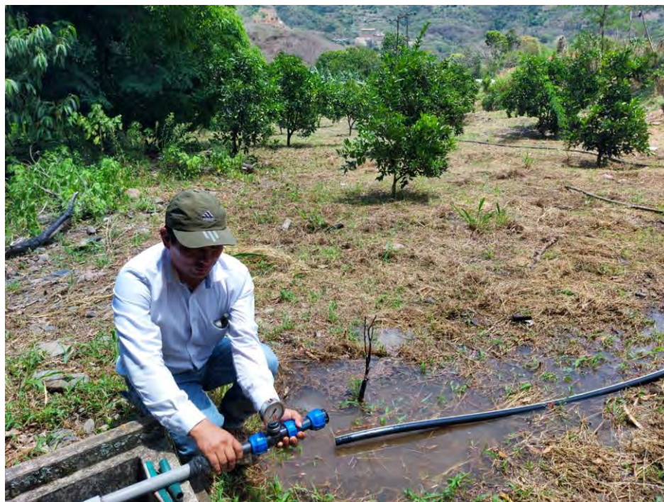
Fotografía 8. Medida de presión de los hidrantes con manómetro.
