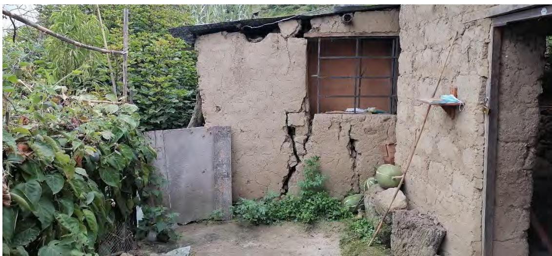
Figura 16 Instalaciones del galpón deteriorado por los años
