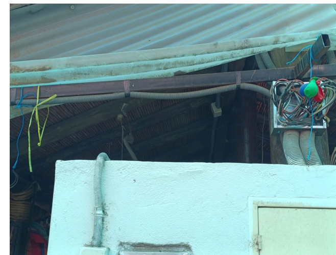
Figura 15 Sistema Eléctrico expuesto
