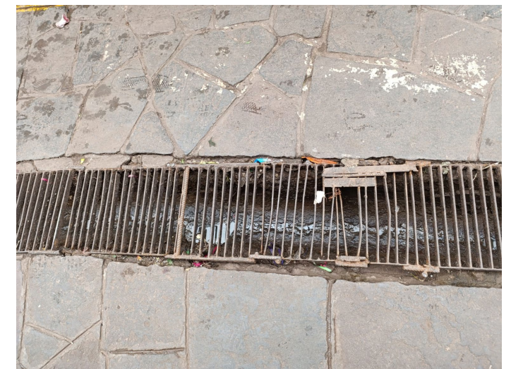
Figura 16 Sistema de drenaje por pesadillos y en mal estado
