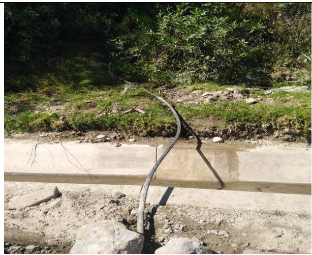
Fotografía 27: línea de conducción de agua para riego
