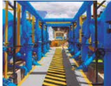
Figura 3. Válvulas de control de los filtros Degrémont.
