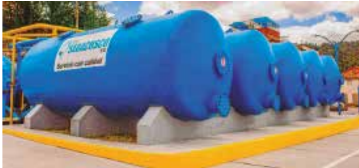
Figura 2. Imagen de los 10 filtros Degremon.
