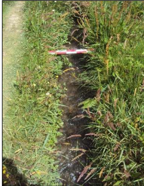
Fotografía 24: Véase el estado de conservación en que se encuentra el canal hidráulico a Q'elloraqay.
