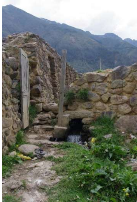
Fotografía 71: Evidencia del canal hidráulico en el sector de Q'ellorakay, este se encuentra por debajo y continuo de los muros de sostenimiento de plataformas agrícolas, presenta deterioro en su recorrido.
