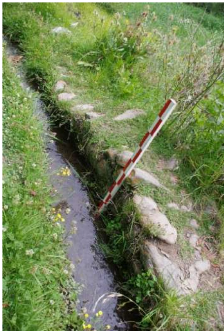
Fotografía 72: Tramo de canal en el sector de Q'ellorakay, este presenta algunos elementos líticos que delimitan y delinear el canal, se evidencian tramos con agua estancada, no se realiza ningún tipo de mantenimiento.
