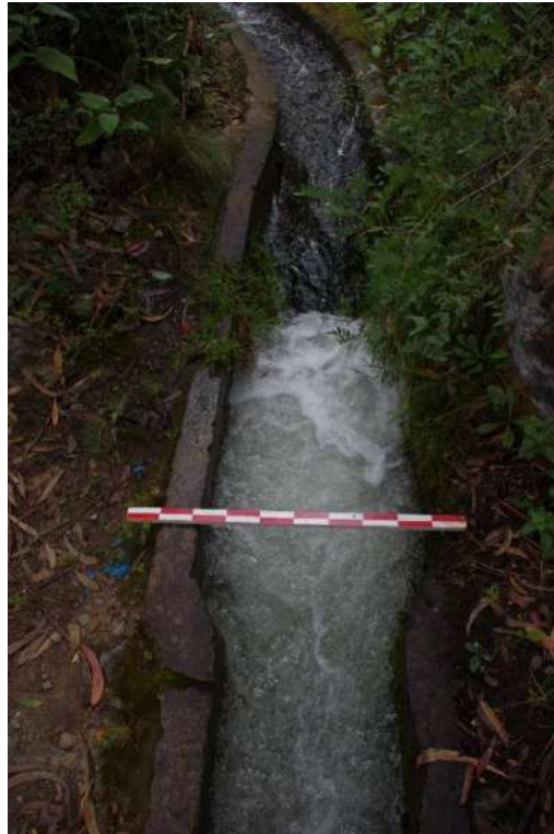
Fotografía 50: Evidencia de la morfología del canal hidráulico en el sector de Qoñaq Huaylla, reconstruido con concreto.
