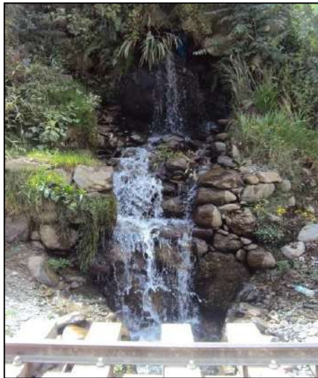
Fotografía 27: Nótese el estado de conservación y el abandono en el que se encuentra.
