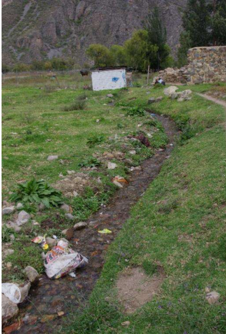
Fotografía 74: Tramo de canal en estado de abandono y deterioro, se puede observar basura al interior y exterior del mismo, así como también agua estancada.
