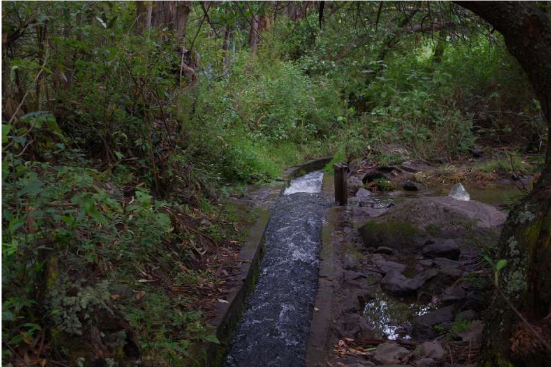
Fotografía 48: Continuidad del canal hidráulico del sector Qoñaq Huaylla, este continua un buen tramo construido con concreto, pero mantienen el recorrido original y presenta suave pendiente.
