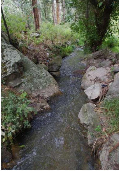
Fotografía 52: Continuidad del canal hidráulico en el sector de Qoñaq Huaylla, se ha perdido las paredes del canal, así como la posible solera.
