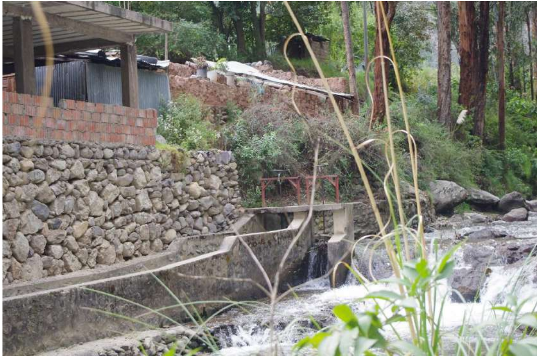
Fotografía 46: Bocatoma e inicio del sector Qoñaq Huaylla, este ha sido construido con material nuevo, con concreto y se distribuye hacia dos sectores
