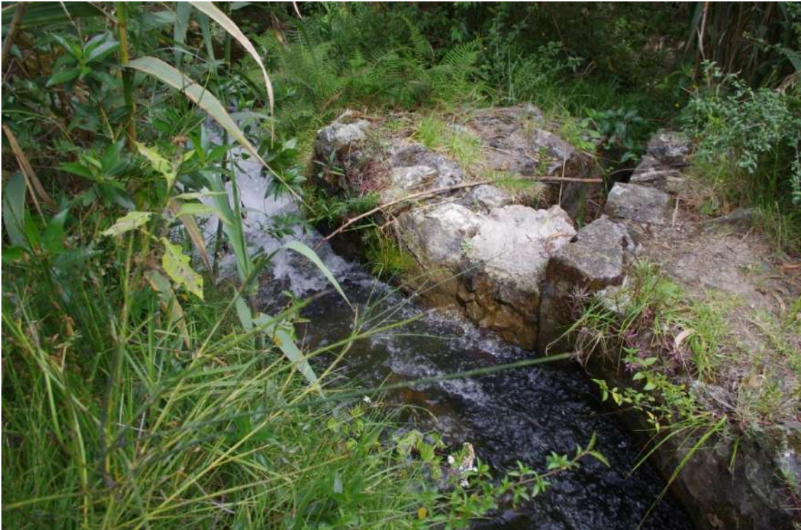
Fotografía 55: Canal hidráulico con pérdida de paredes laterales y solera, se puede observar un desvío antiguo el que se encuentra sellado.
