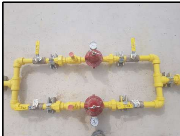
Figura 80: sistema de regulación primera etapa en la línea de vapor
