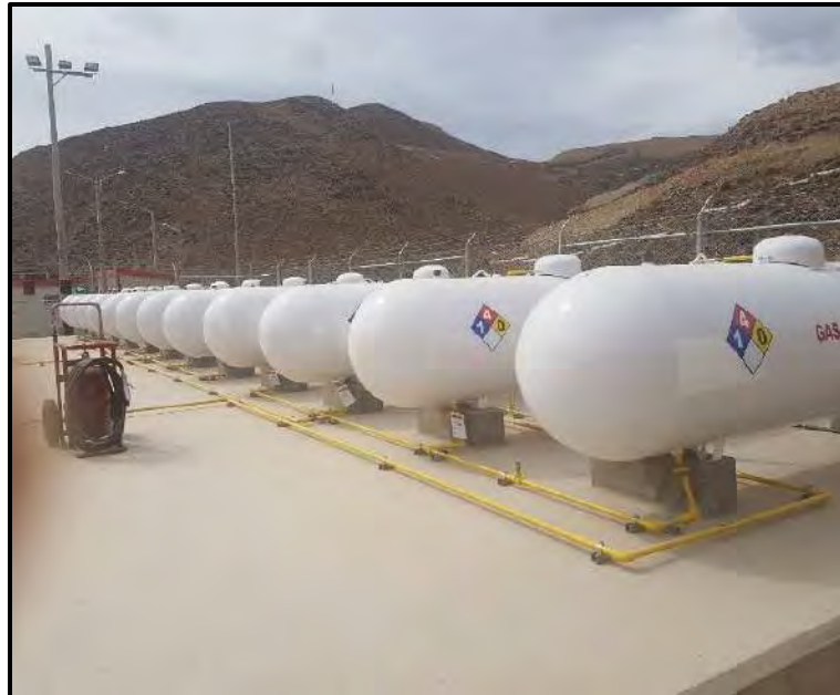
Figura 73: vista de la zona de tanques con sus conexiones respectivas.
