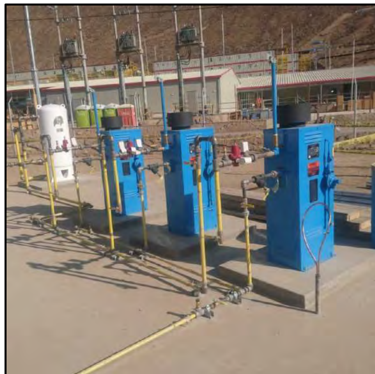
Figura 74: vista de vaporizadores con las conexiones respectivas
