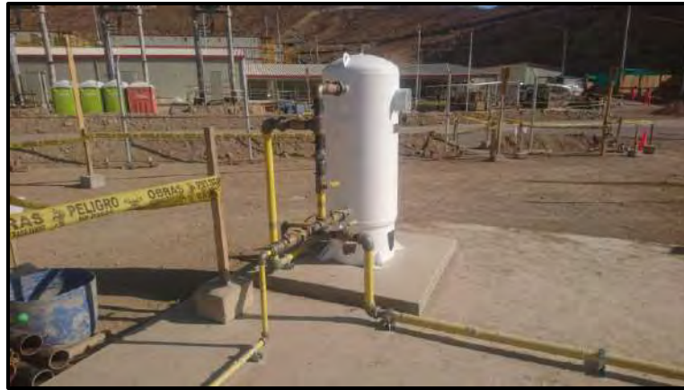
Figura 75. Vista del decantador con las conexiones respectivas
