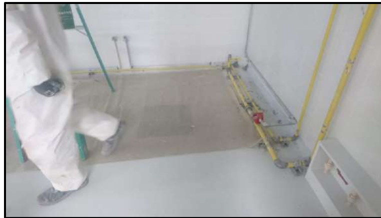
Figura 83: Tubería de baja presión
