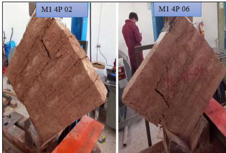
Figura 75. Falla de cortante
