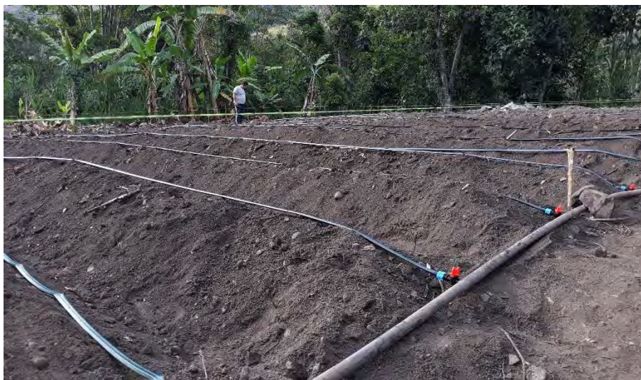
Fotografía 7: Módulo de riego por goteo
