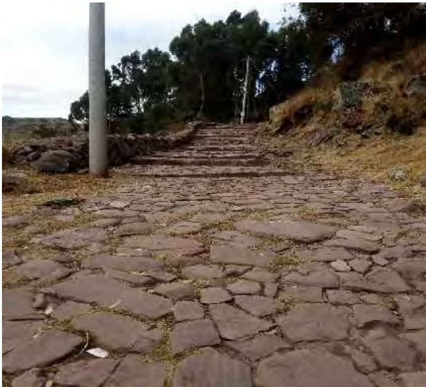
SECTOR DE LLAQUEO HUAYLLA.- Proyección del camino real del Contisuyo. FUENTE: Propia Tesista.
