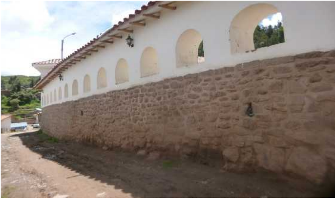
FACHADA DEL MURO DEL TEMPLO RESTAURADO DE SANTIAGO APOSTOL DE CCORCA. - Presencia de cimientos líticos inca que fueron restaurados por la Dirección Desconcentrada de Cultura Cusco. FUENTE: Propia Tesista
