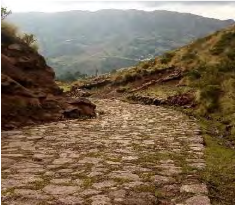
ABRA DE LLAULLI Q´ASA.- El camino real se halla en buenas condiciones con la presencia de canales y drenes. FUENTE: Propia Tesista
