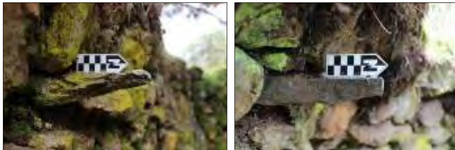
Figura 72. Detalle de las clavijas que sobresalen del muro, estructura C-02. Fuente: Propia
