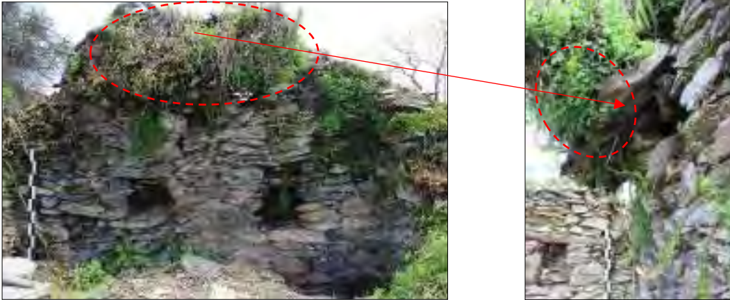
Figura 106. Detalle de la cubierta en la estructura 01, nótese la abundante vegetación lo que produjo el colapso. Fuente: Propia
