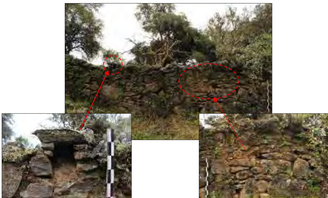
Figura 36. Detalle del paramento interno donde se evidenció una hornacina y restos de revoque. Fuente: Propia
