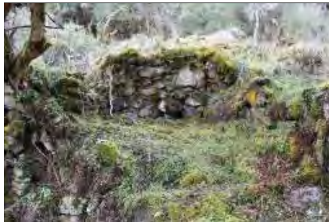
Figura 60. Vista del muro colapsado, estructura B-08. Fuente: Propia
