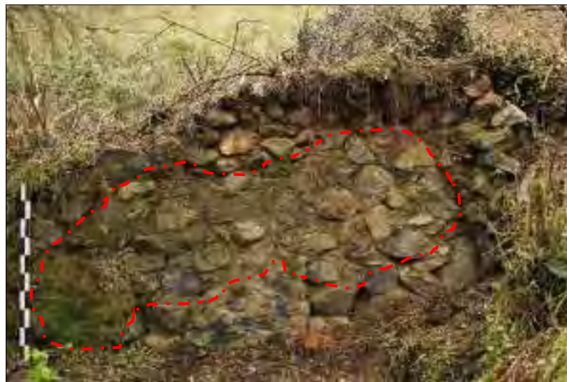
Figura 79. Detalle de restos de revoque del paramento interno de la estructura C-01. Fuente: Propia
