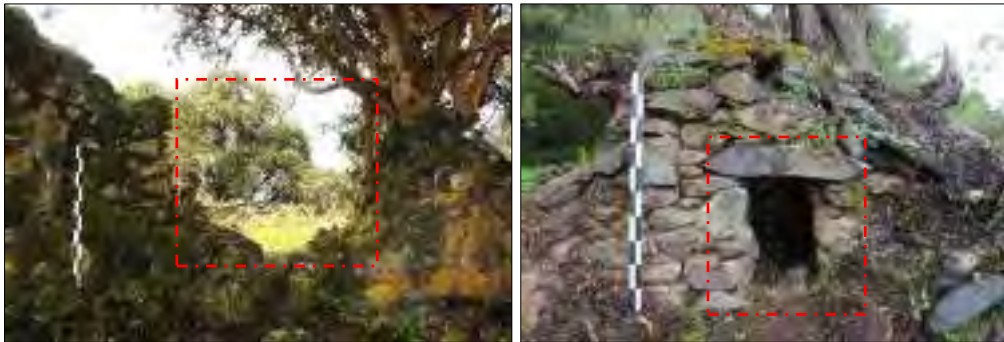
Figura 94. Vano de acceso de la estructura C-02 y C-07 respectivamente, el primero ubicada al oeste que conecta a un espacio abierto (patio) y el segundo con orientación al suroeste. Fuente: Propia
