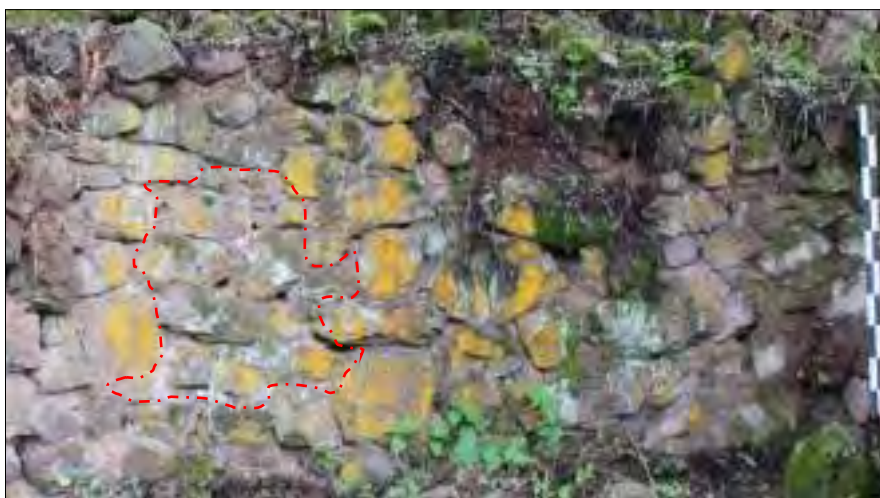
Figura 46. Estructura A-06 donde se evidenció restos de revoque. Fuente: Propia
