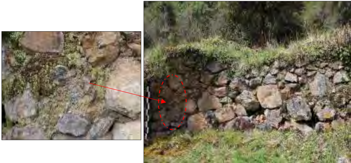
Figura 55. Detalle del paramento interno donde se evidenció restos de revoque, estructura B-05. Fuente: Propia
