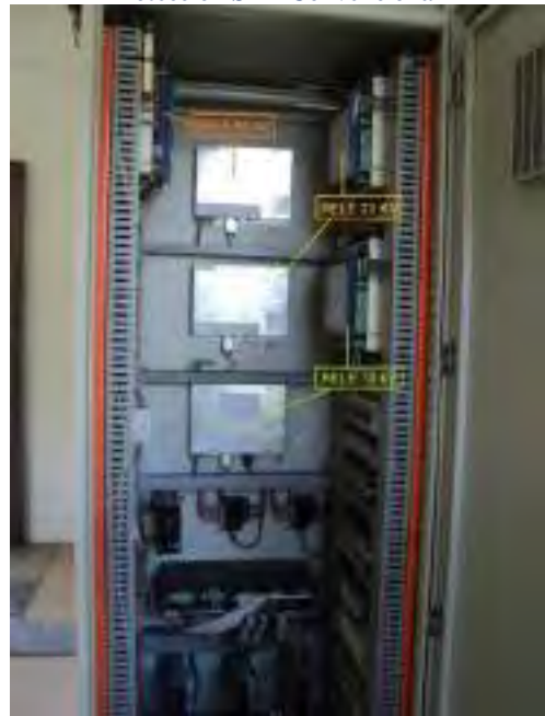
Figura 51 - Vista interior, Tablero Control y Protección SET Convencional
