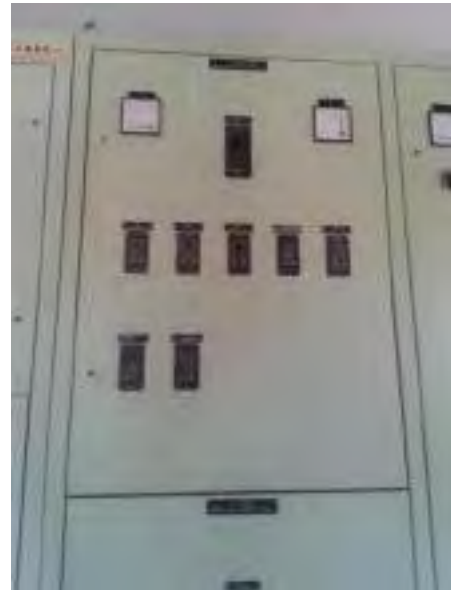
Figura 57 - Tablero de distribución de SSAA.
