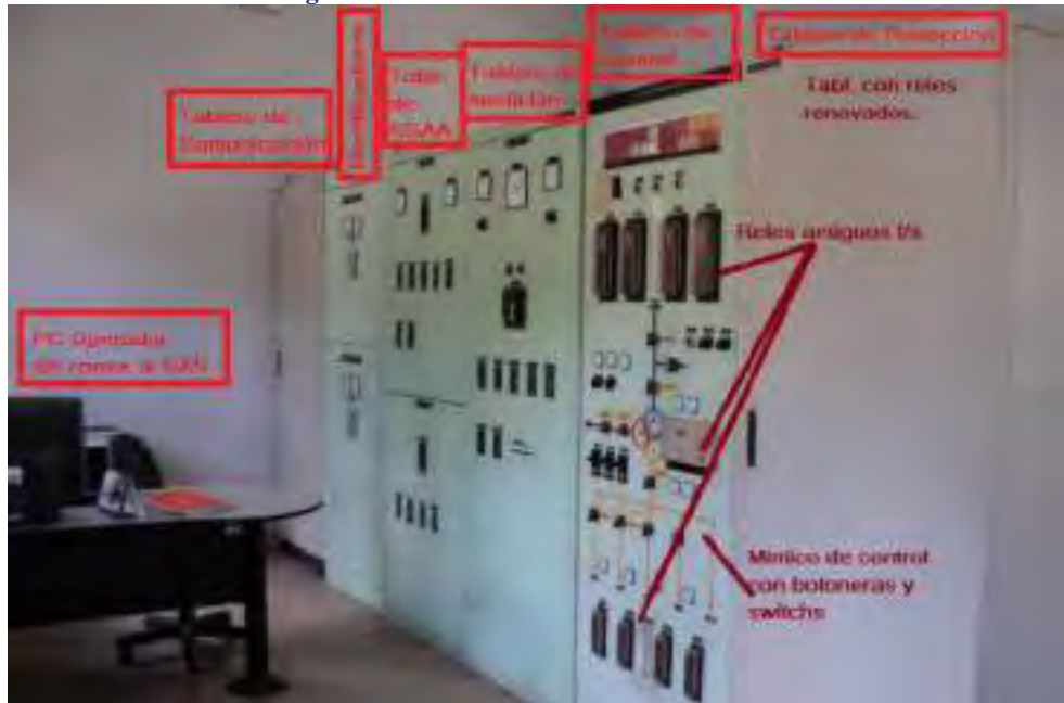
Figura 49 - Tableros de una SET Convencional
