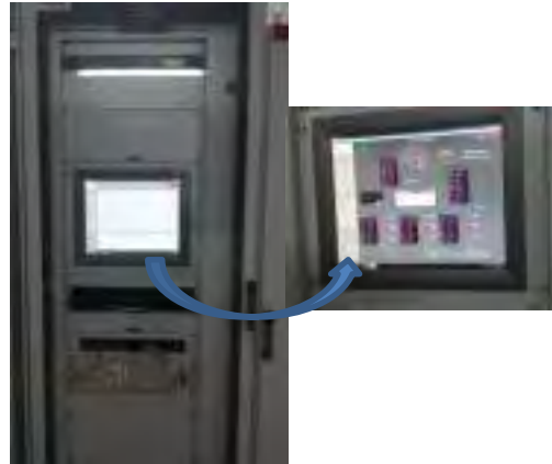
Figura 7 - HMI para control en una sala de control de una SET moderna.
