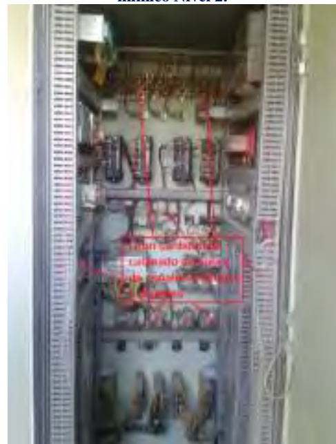
Figura 53 - Vista interior, Tablero Control mímico Nivel 2.
