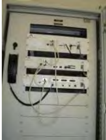
Figura 55 - Tablero de comunicación para señal de Onda Portadora
