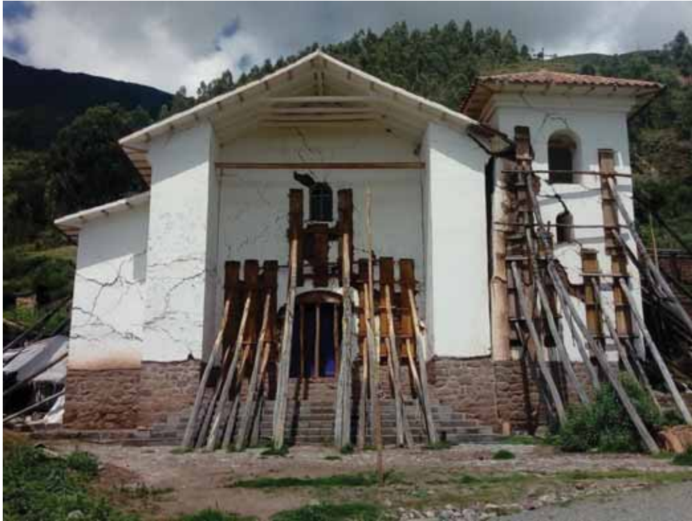
Templo colapsado en la comunidad de
