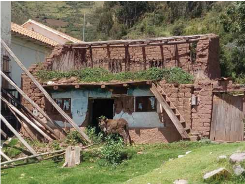
Vivienda colapsada en la comunidad
