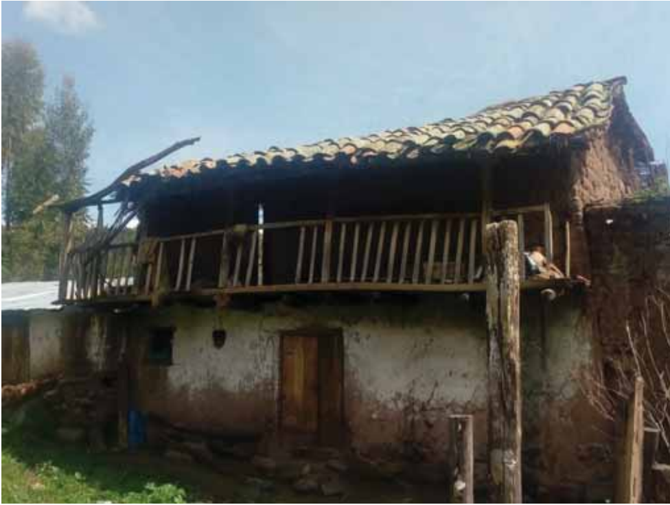
Vivienda colapsada en la comunidad
