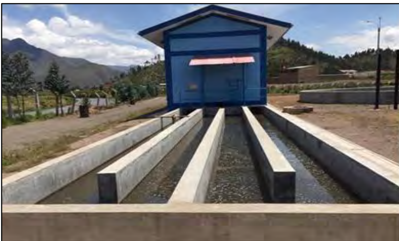
Cámara de contacto de cloro
