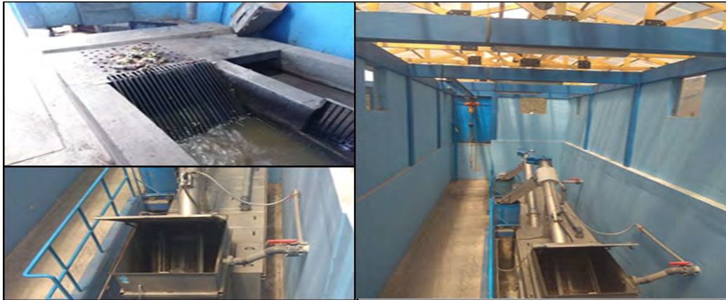
Cámara de rejillas y desarenador de la PTAR Sicuani
