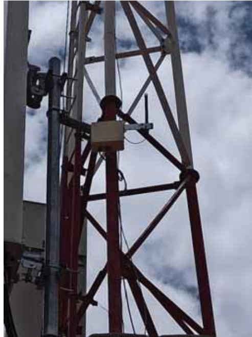
Figura 22: Gateway instalado (Elaboración propia).
