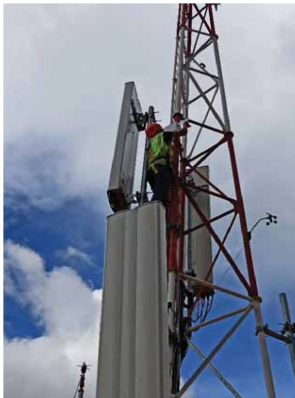
Figura 21: Instalación de gateway en torre la torre de comunicaciones (Elaboración propia).
