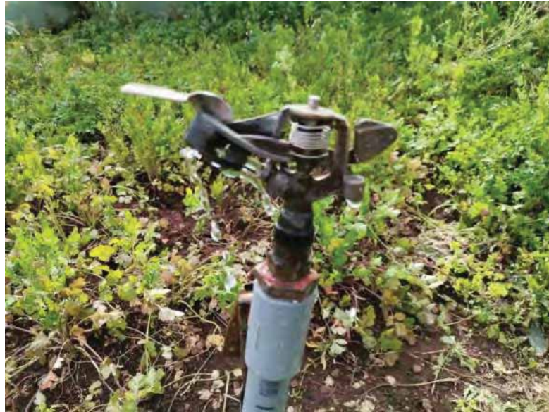
Foto. Aspersor utilizado para el riego dentro del fitotoldo
