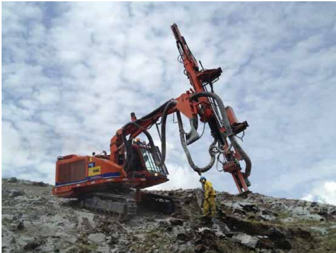
Imagen 11: Rock Drill Tamrock Ranger 500
