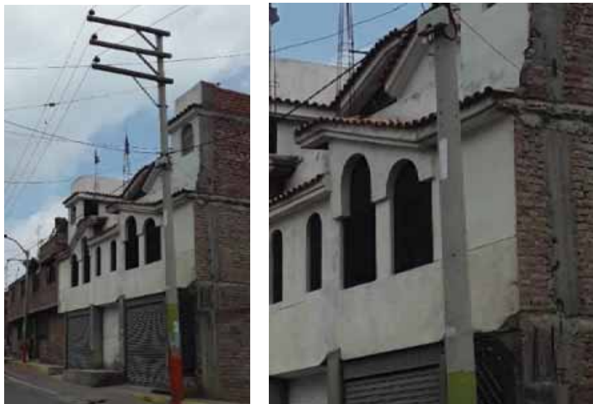
Figura 7-6. Falta de señalización de riesgo y peligro en las estructuras de la concesionaria SEAL
