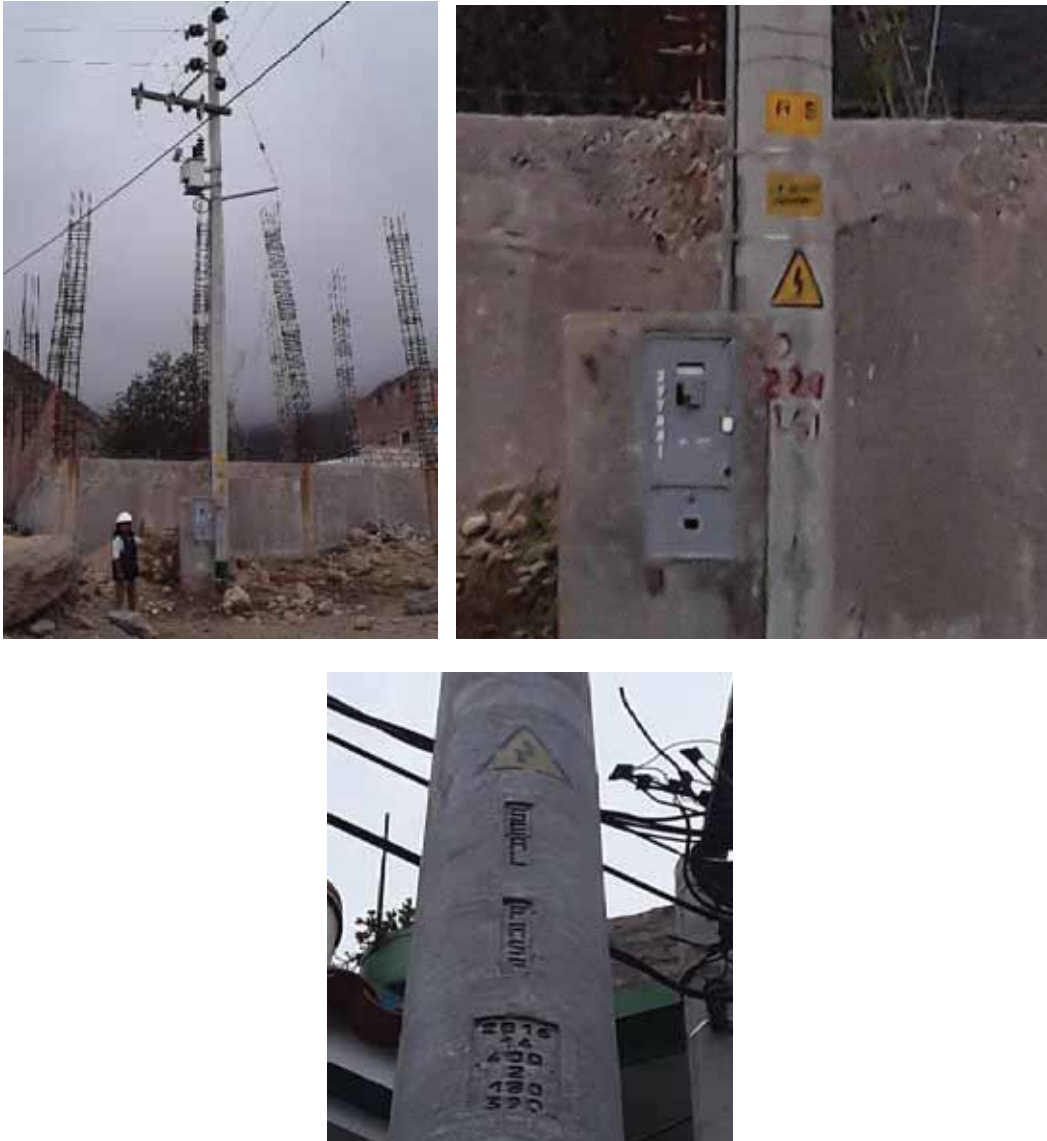
Figura 7-7. Señalética de riesgo y peligro en las estructuras de la concesionaria SEAL
