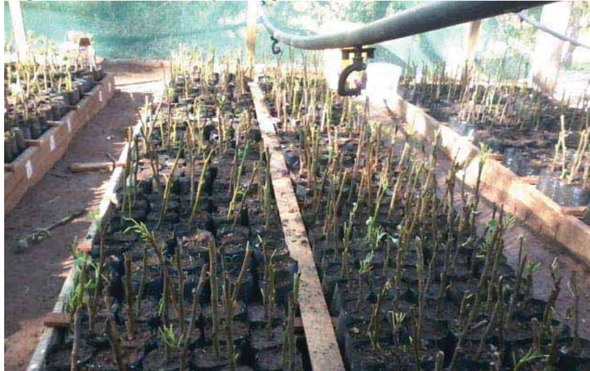
Fotografía 13: Difusores y manguera HDP instalado sobre las camas
