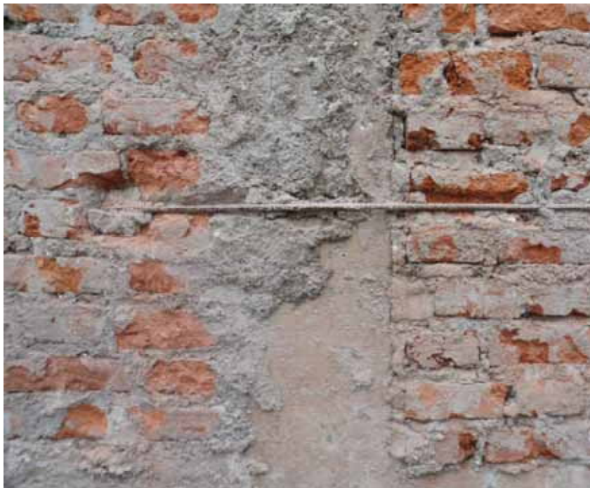
Figura 5.1-2 Encuentro entre columnas de concreto armado y muros de albañilería de las edificaciones del conjunto vecinal Zarumilla.
