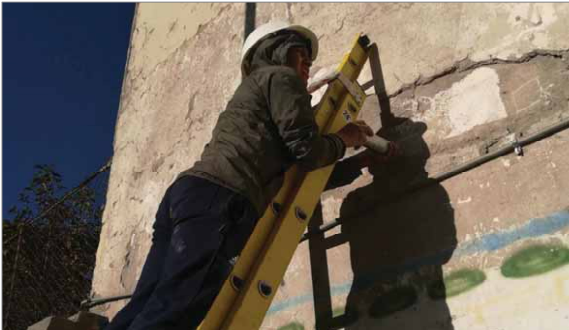
Figura 09: Ensayo de esclerometría en viga y columna de segundo nivel. (Fuente: Elaboración propia).
