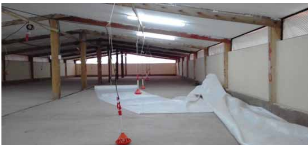
Fotografía 2: Instalación para sistema de crianza intensivo
