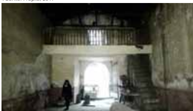
FIGURA 245. El coro presenta desprendimiento de revestimiento y erosión. Fuente: Propla, 2017
