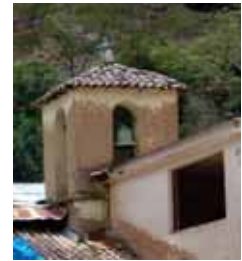
DESPRENDIMIENTO DE ENCALADO EXTERIOR
