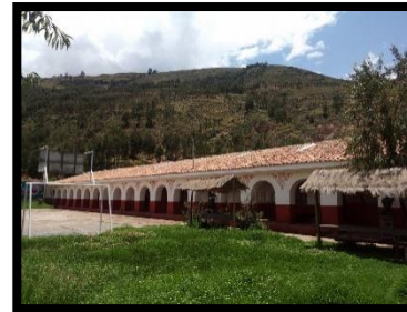
IMAGEN 10: Espacios de Recreación Deteriorados – Sede Checacupe. FUENTE: Imagen Propia 2018.
