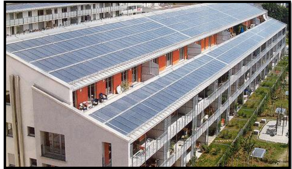
IMAGEN 133: Paneles Fotovoltaicos en Cubiertas. FUENTE: Imagen Propia.
