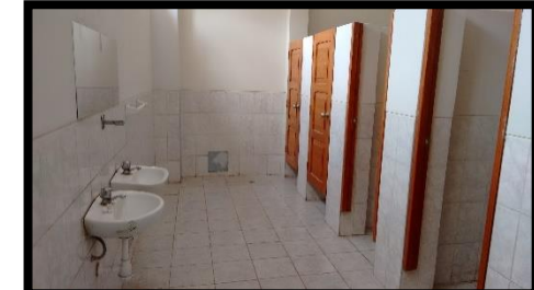
IMAGEN 14: SS. HH. Inadecuados – Sede Calca. FUENTE: Imagen Propia 2018.
