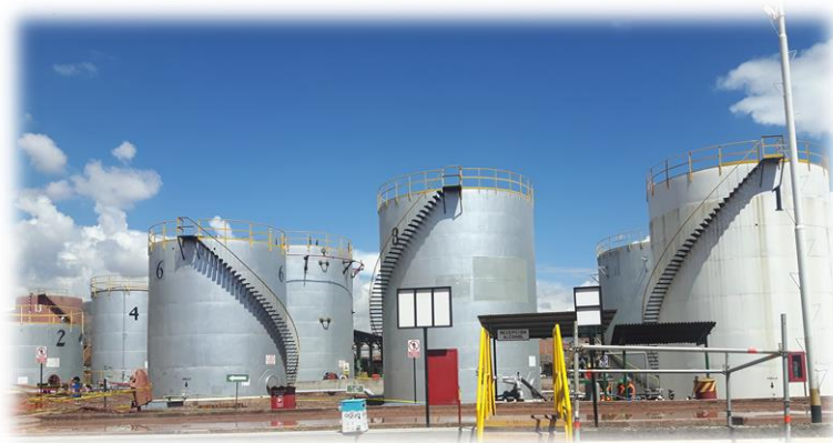
Figura 1.4 -Tanques de almacenamiento de combustible. Fuente: Elaboración propia.
