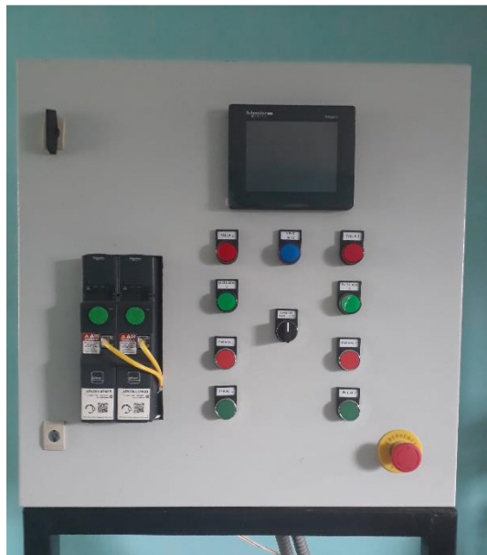
Figura 4.19 - Vista frontal del tablero de control. Fuente: Elaboración propia.
