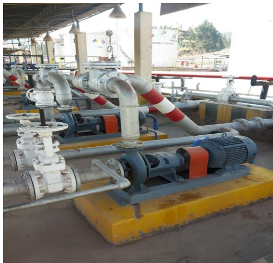
Figura 3.7 - Patio de bombas para la recepción y distribución de producto. Fuente: Fotografía tomada en planta.
