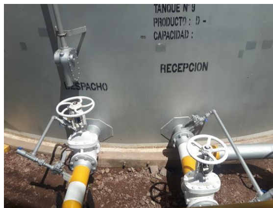
Figura 3.3 - Válvulas de control a la entrada y salida del tanque. Fuente: Fotografía tomada en planta.
