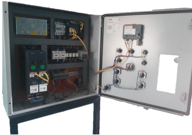
Figura 4.20 - Interior del tablero de control. Fuente: Elaboración propia.
