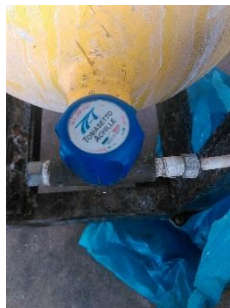
Fotografía 29. Válvula del Tanque de GNV.
